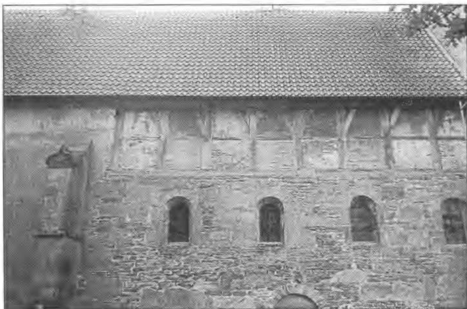
Detail van de noordelijke gevel van het kerkje. Duidelijk is het vakwerk te zien in die wand.
