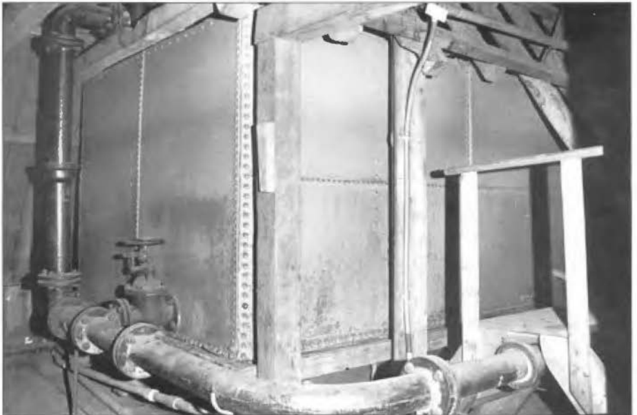
Reservoir op zolder zuidkant, opname 1977
