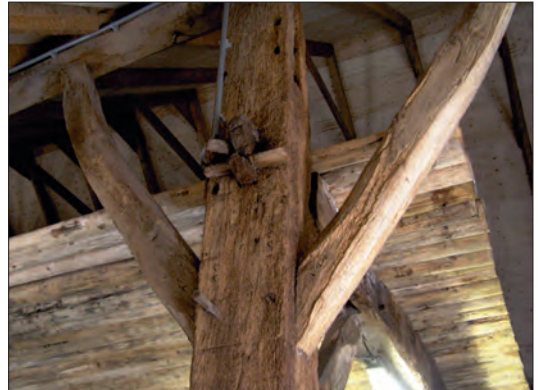
Detailfoto van de ankerbalkconstructie. Op de gebintstijl en op de twee schoren (of korbelen) zijn telmerken zichtbaar. Gebinten werden eerst op maat gemaakt en vervolgens, op de plek van bestemming, in elkaar gezet.
